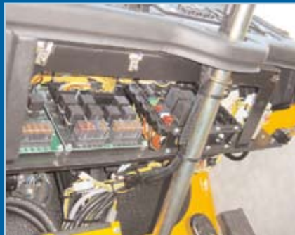
Zugang elektrische Installation
